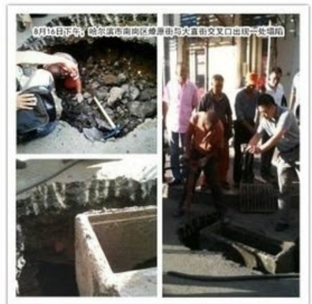
埃德蒙顿路塌陷大坑
