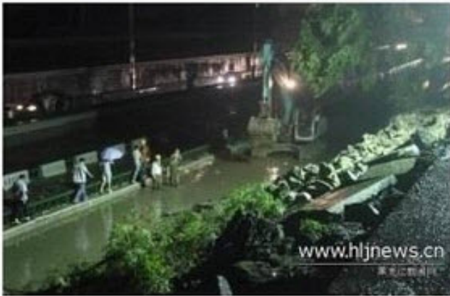
先锋地道桥挡墙坍塌
